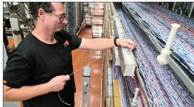
Michaël Berthomier entretient le réseau cuivre dans ce central de télécommunication. (Photo A. R.)
